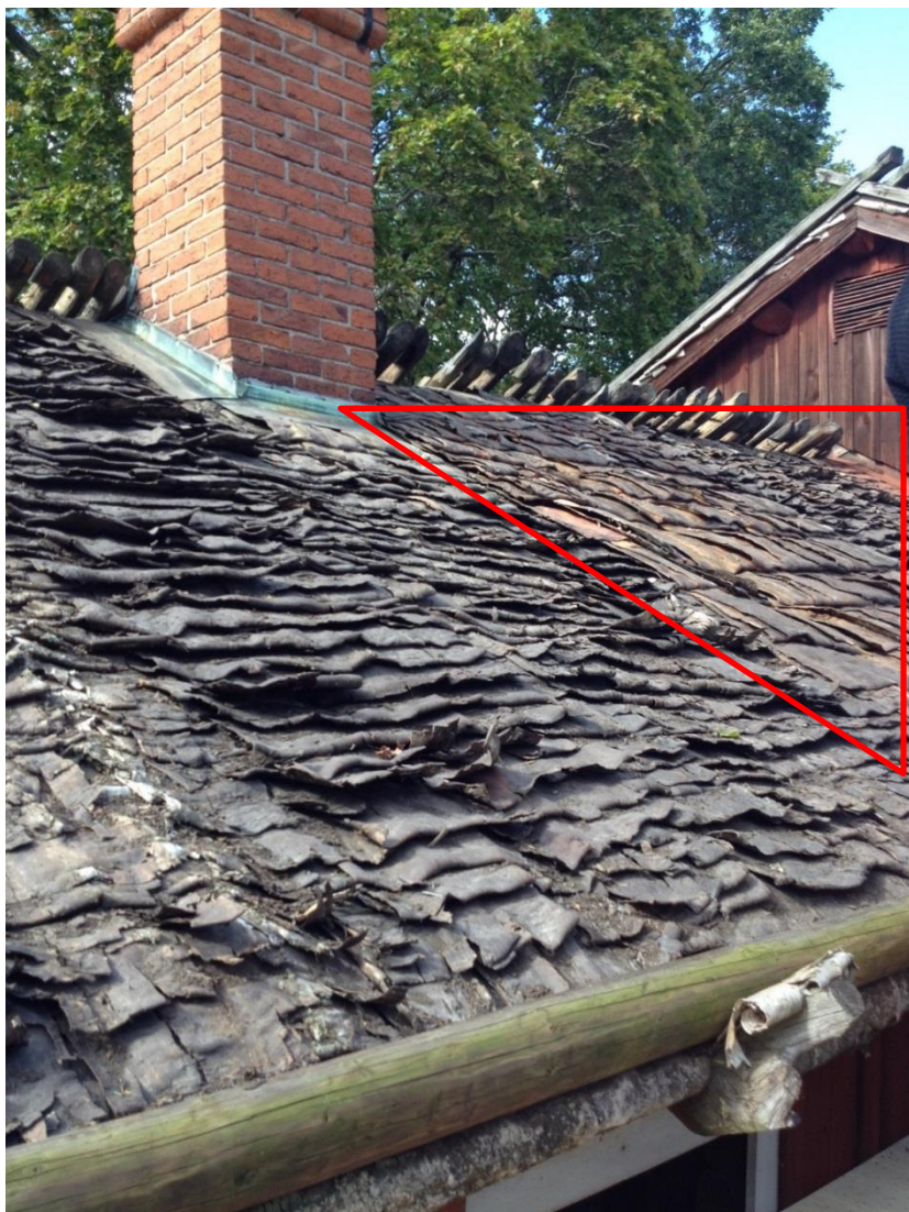
T.v. Den röda markeringen visar på den sekundära näverlagningen som utförts under senare tid. Denna bit hade flera skarvar och höll inte tätt.
